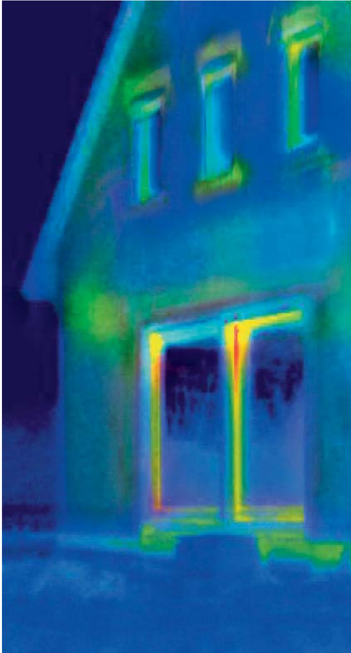
Prije renoviranja: na slici su crvenom bojom prikazani veliki gubici topline.
